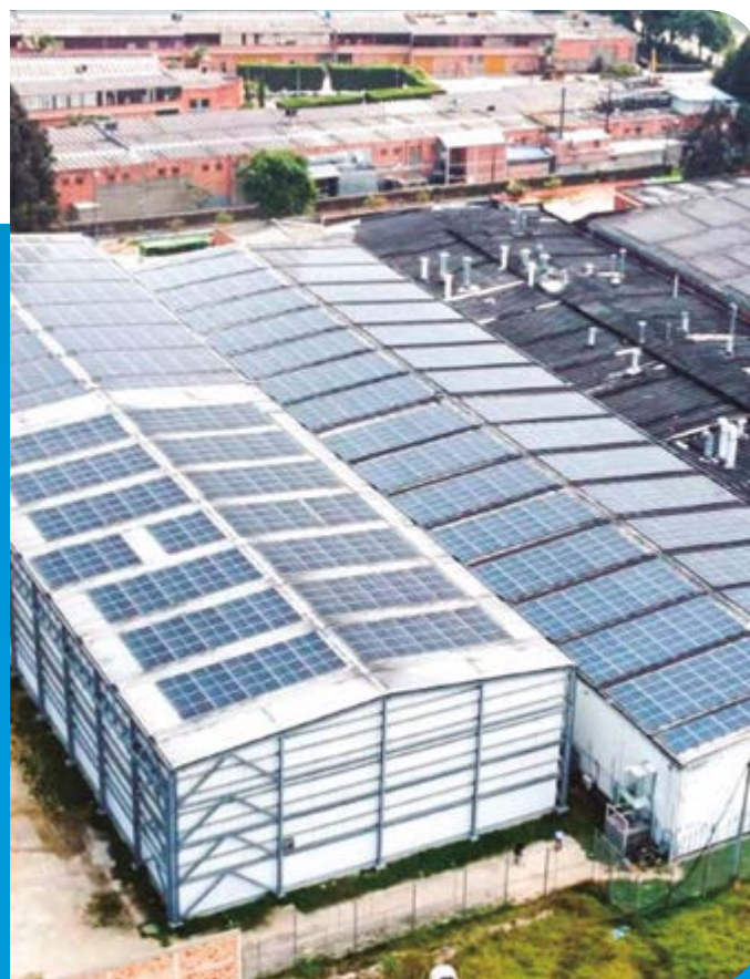
PANELES SOLARES PLANTA 2
